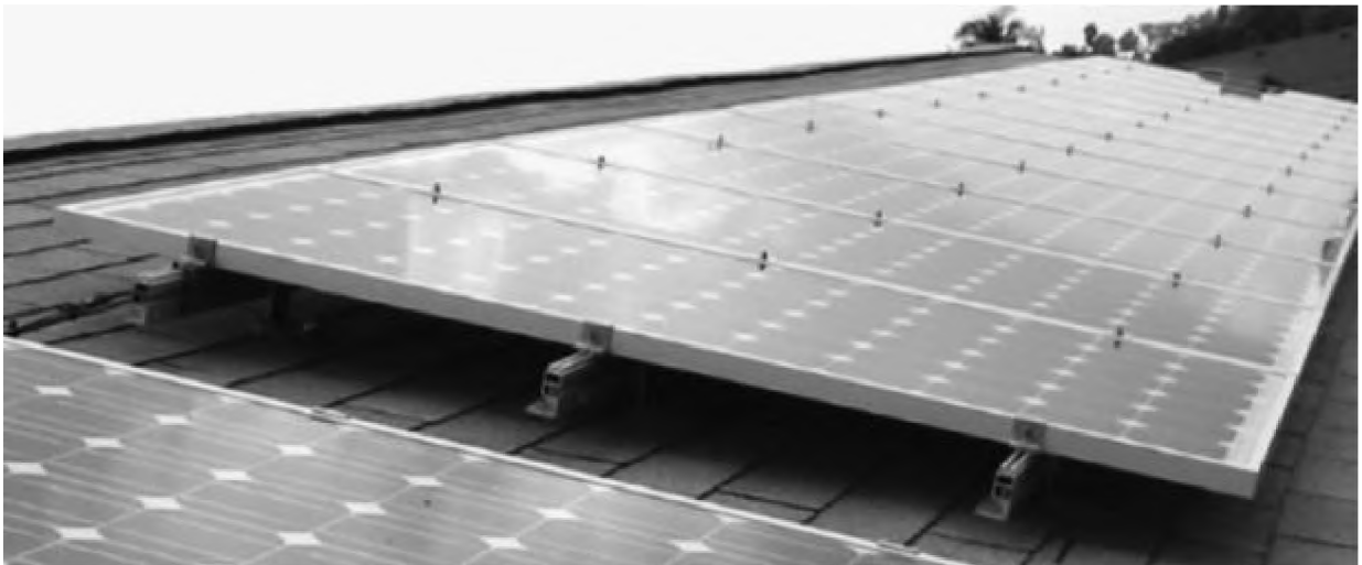
Рисунок 1.3 – Стійковий монтаж забезпечує достатню висоту, що сприяє хорошій циркуляції повітря під панелями
