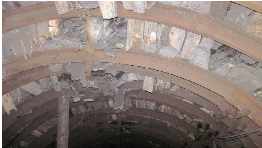
Рис. 2.10. Стан елементів кріплення південного конвеєрного штреку у районі ПК5
