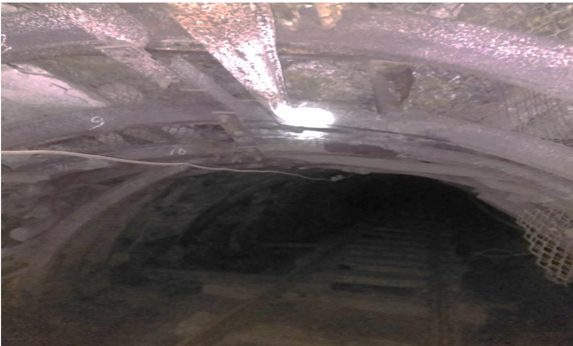
Рисунок 2.7 - Фото деформацій рам кріплення в 11му північному вентиляційному штреку(на початку виробки) похилу №1 пласта l_2'
