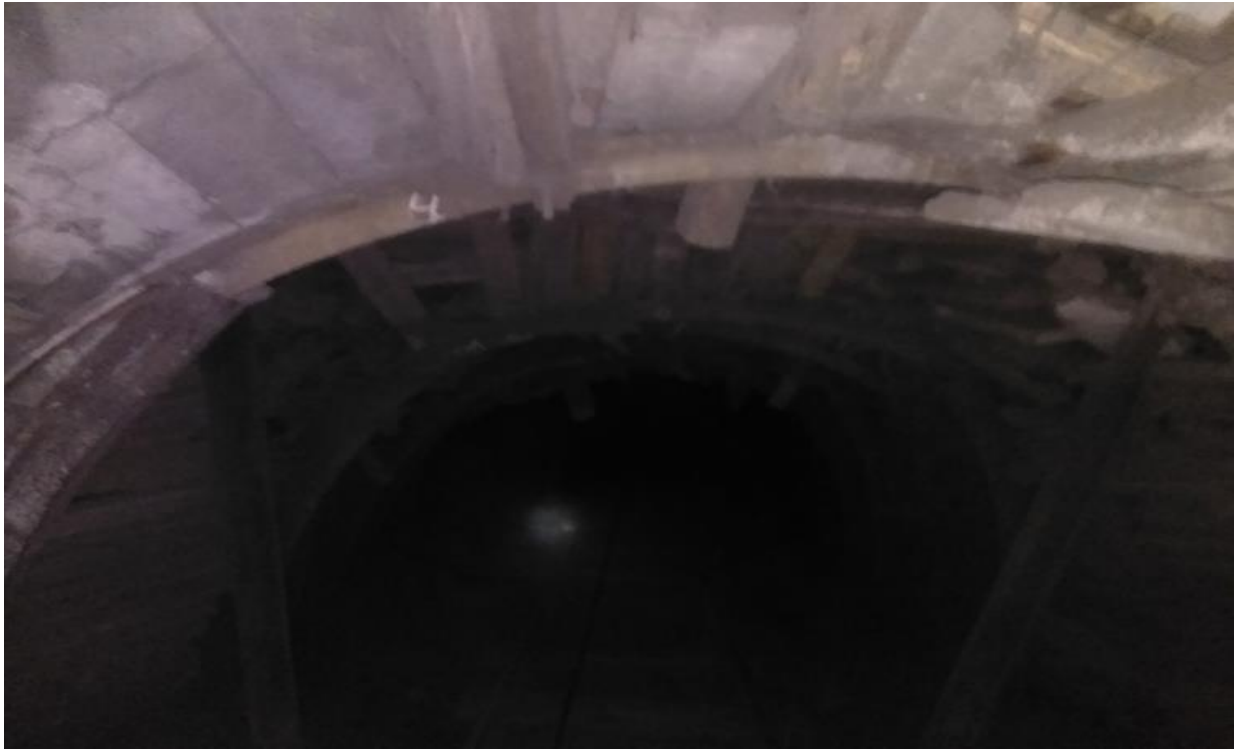
Рисунок 2.20 - Фото деформування 12го вентиляційного штреку
