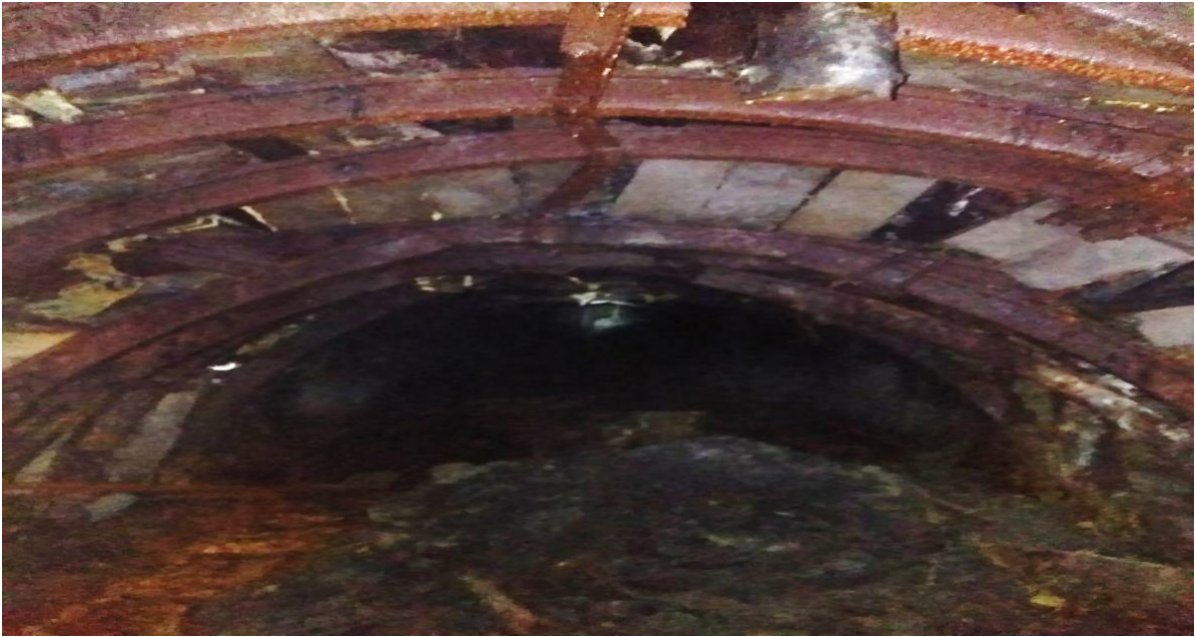
Рисунок 2.6 - Фото деформацій кріплення в 11-му північному вентиляційному штреку похилу №1 пласта l_2'
