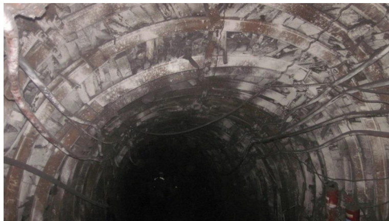
Рис. 2.15. «Завалювання» рам кріплення в південному конвеєрному штреку
