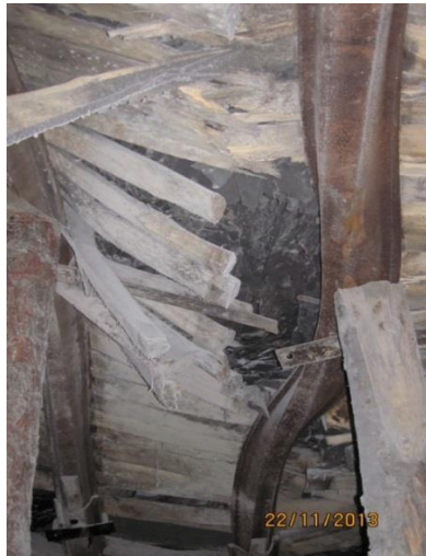
Рис. 2.16. Кручення стійки рамного сталевого кріплення південного конвеєрного штреку у районі ПК30-ПК32
