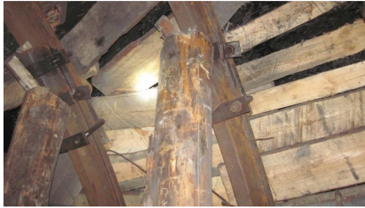
Рис. 2.14. Стан замків південного конвеєрного штреку у районі ПК11-15
