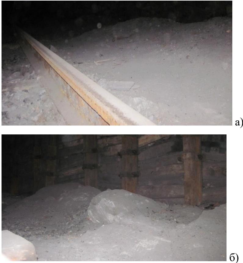
Рис. 2 .11. Стан порід підосви південного конвеєрного штреку у районі ПК15: а) спотворення профілю рейкової колії; б) форми плит порід, видавлених із підосви гірничої виробки
