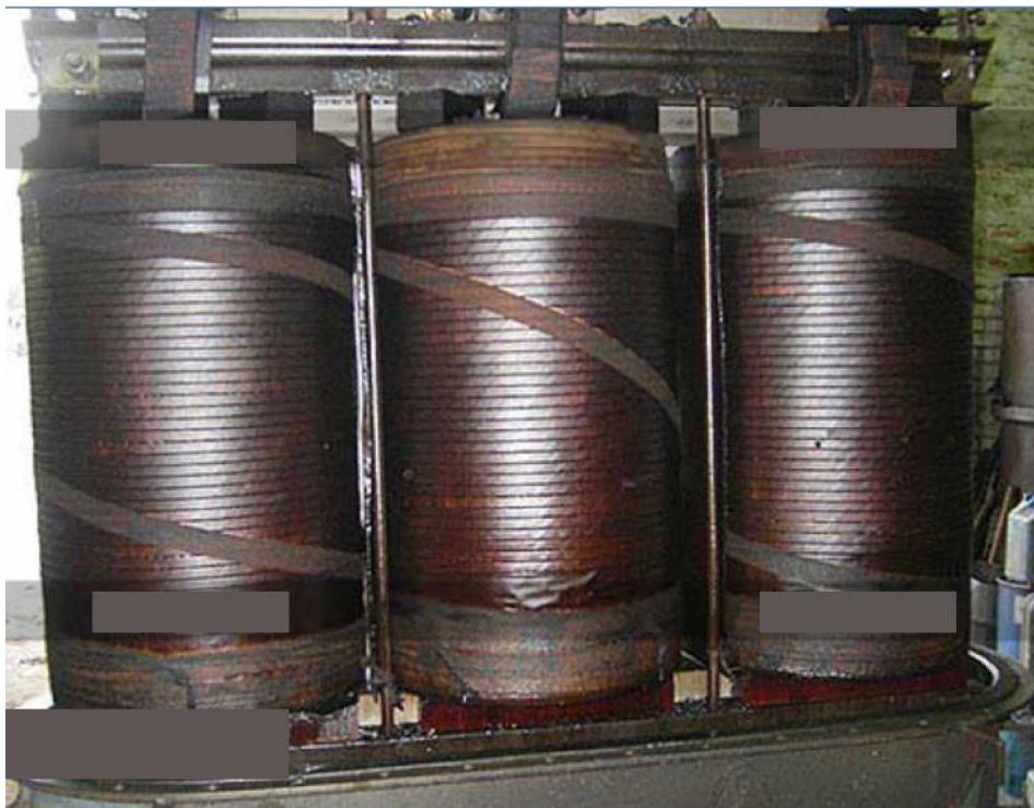
Рисунок 1.2 – Зношення ізоляції внаслідок нагріву і коксоутворення оливи (грілися місця з'єднання демпферів з виводами низької напруги)
