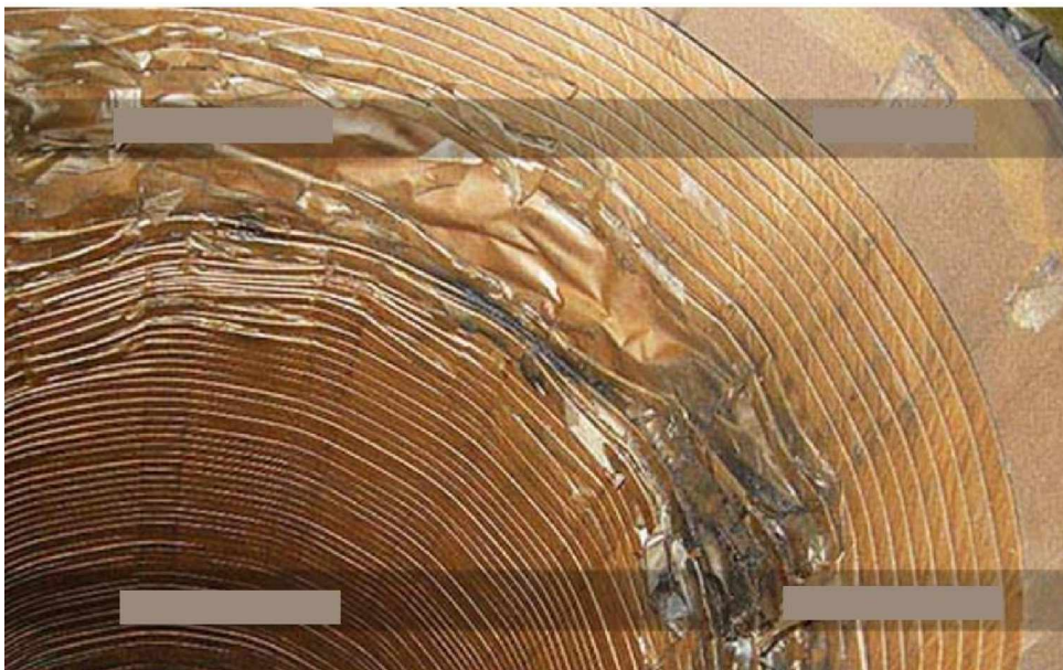
Прогар і механічне пошкодження обмотки високої напруги внаслідок потужного короткого замикання на трансформаторі
