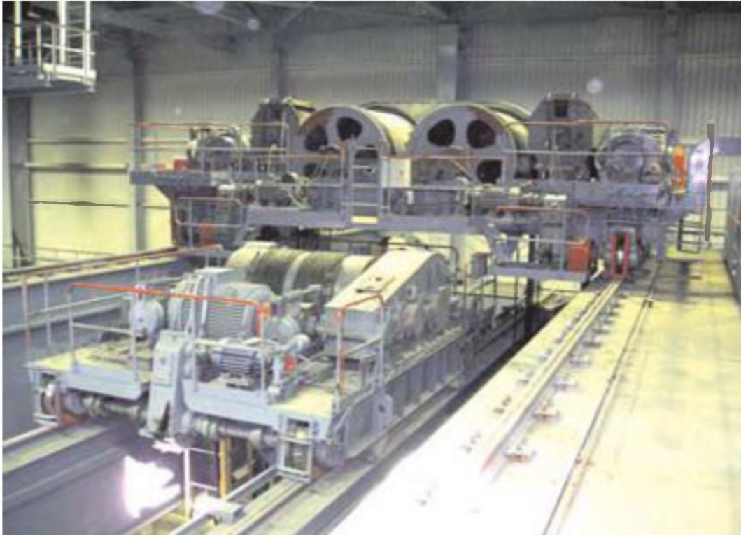
Рисунок 1.1 – Мостовий кран під час експлуатації, вид із електричними приводами
