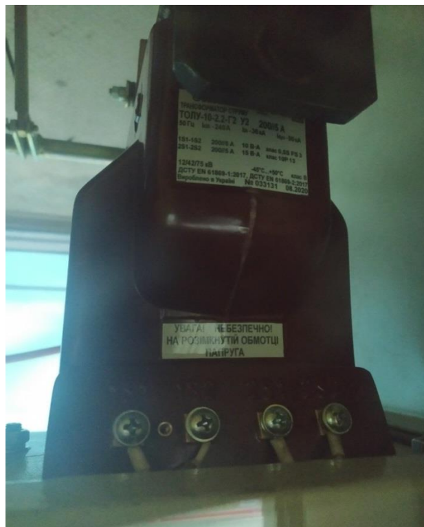
Рис 2.9 – трансформатор струму сторони 6 кВ
