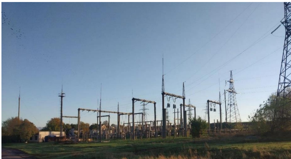
Рисунок 1.4 – вузлова підстанція в селі Ліховка. Дніпровська область.
