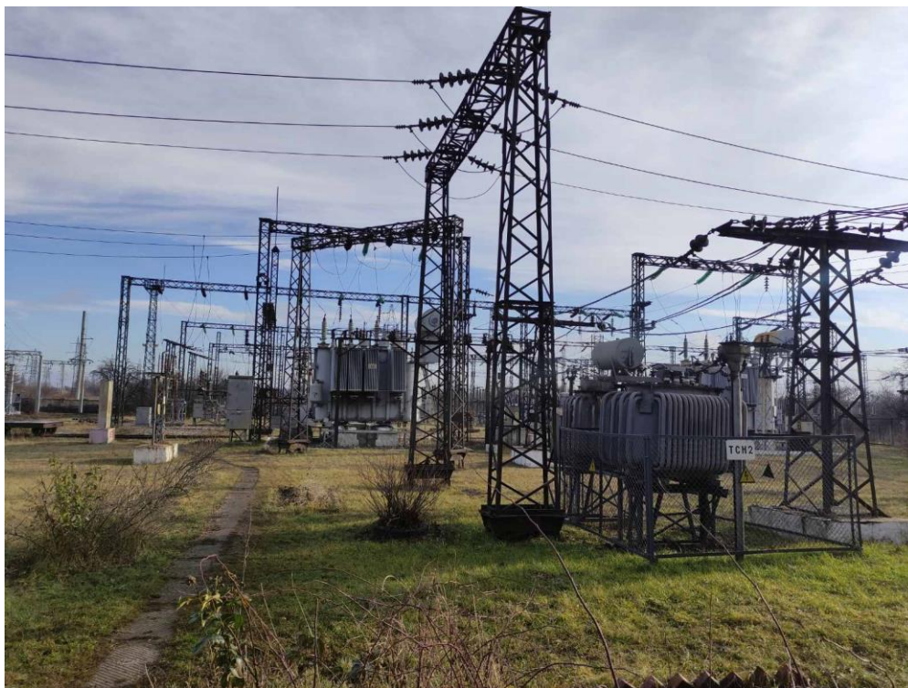
Рис. 1.6 – ВРП 110 підстанції «Покровська 110».
