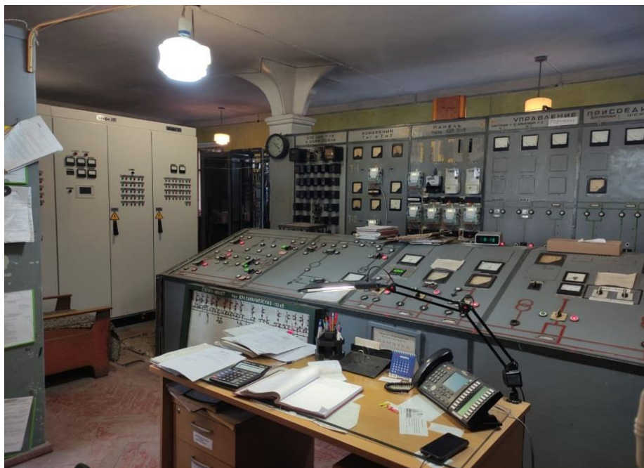
Рис. 1.7 – загальнопідстанційний пункт керування
