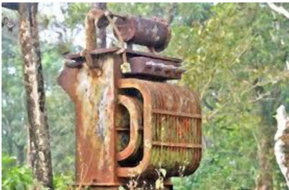
Рисунок 2.1 – Фото застарілого трансформатора в системі електропостачання
