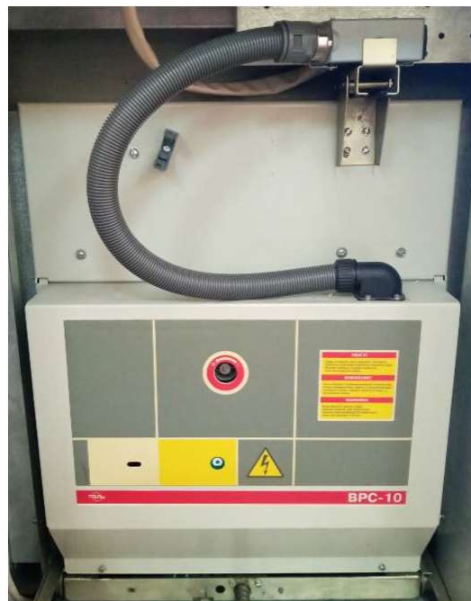
Рисунок 2. Загальний вигляд вакуумного високовольтного вимикача ВРС-10 у складі коміртки КУ-10С, час спрацювання якого вимірювався
