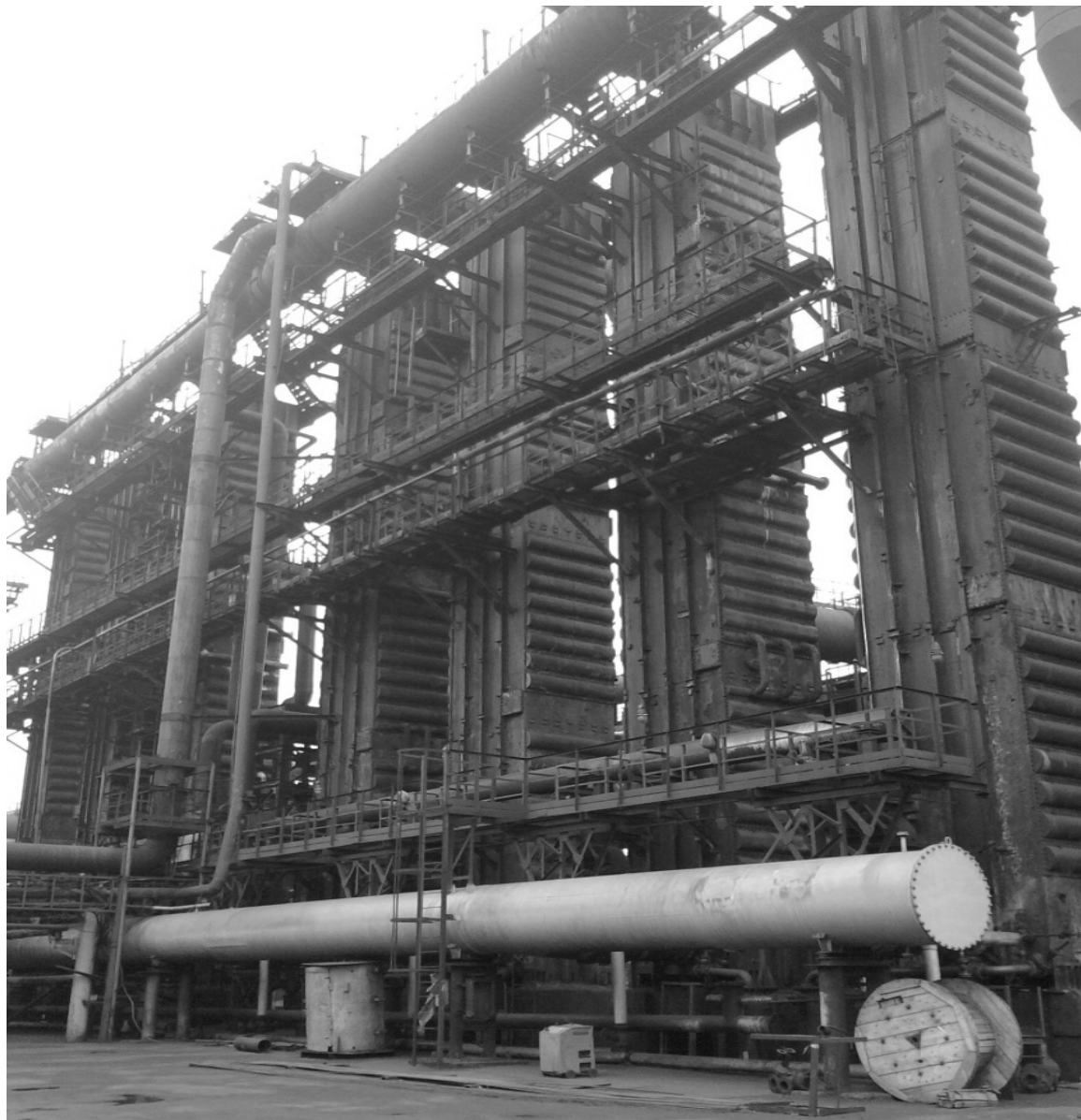
Рисунок 4.4 – Колектор-газопровід прямого коксового газу
