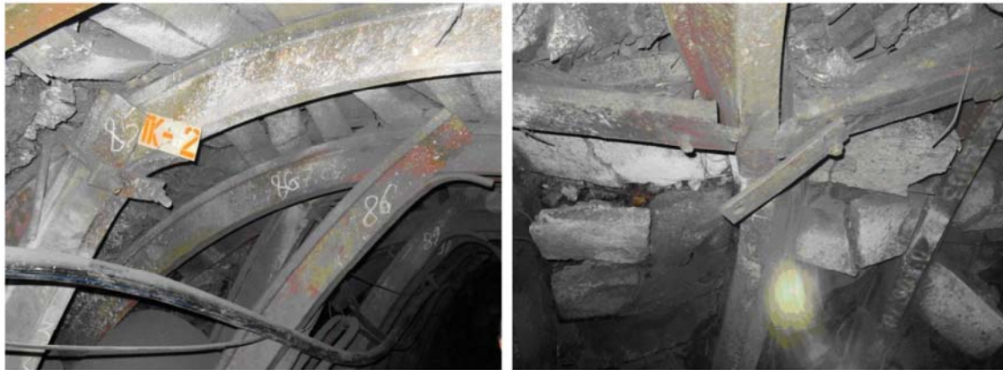
Рис. 3— Загальний вигляд характерних ділянок деформування елементів кріплення виробки
