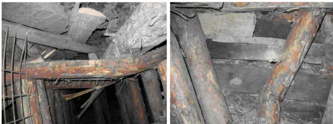
Рис. 5— Загальний вигляд деформування елементів дерев'яного кріплення внаслідок їх неякісної установки
