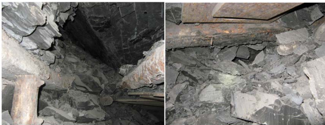
Рис. 4— Загальний вигляд обвалення порід покрівлі позаду секцій кріплення зі зворотньою консоллю
