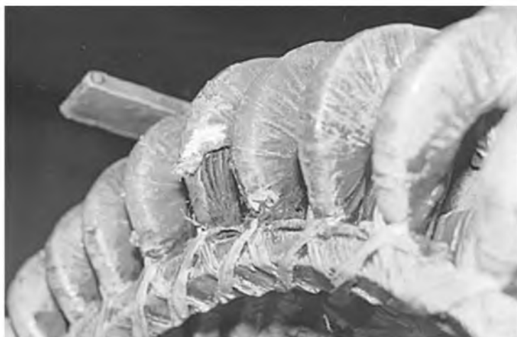
Рисунок 2.2 – Механічне ушкодження ізоляції обмотки статора [9]
