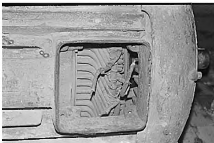
Рисунок 2.8 – Ушкоджені у клемній коробці приєднання обмоток статора [9]
