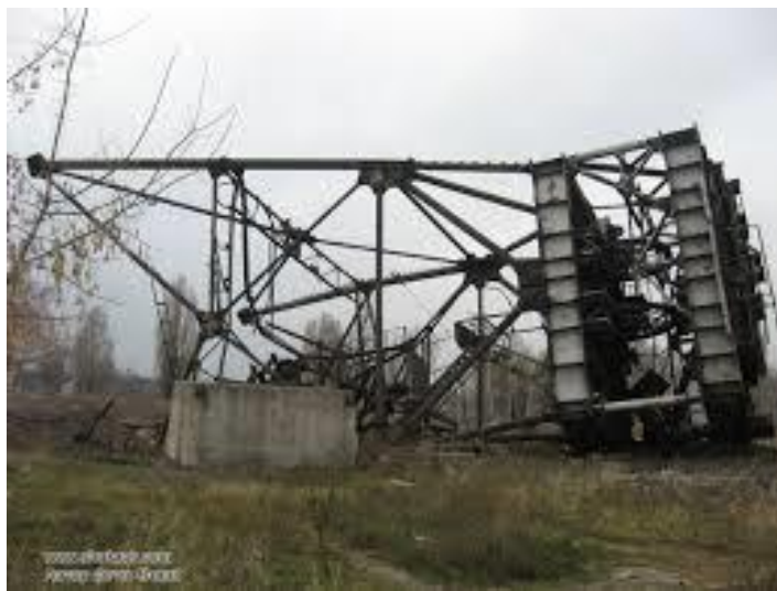
Рисунок 1 – Наслідки порушень конструкції копрів
