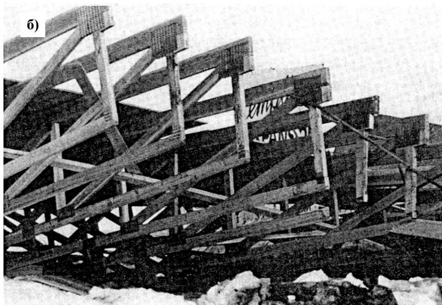
Рис. 6.11. Обрушение кровельных конструкций из-за ураганного ветра в Post Falls, Айдахо а) до обрушения; б) после обрушения.
