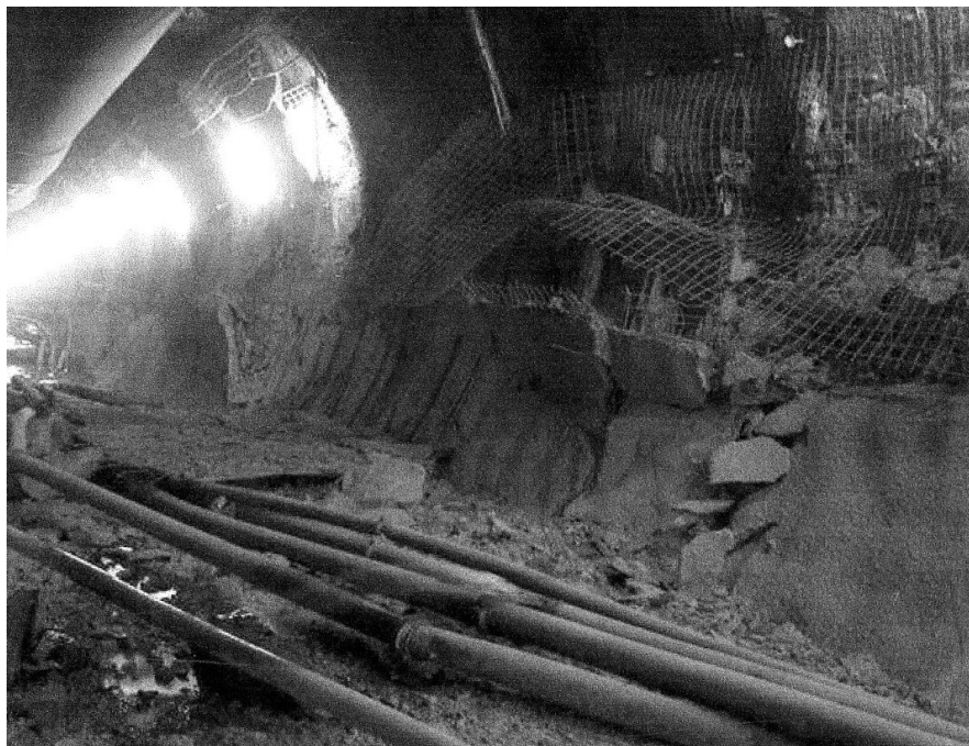
Рис. 4.19. Повреждение внезапным выбросом стены закрепленного туннеля
