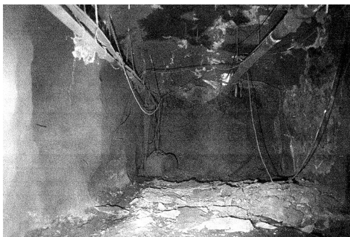
Рис. 2.74. Пересечение квершлага 326 штреком после сейсмический явлений октября 2000г.
