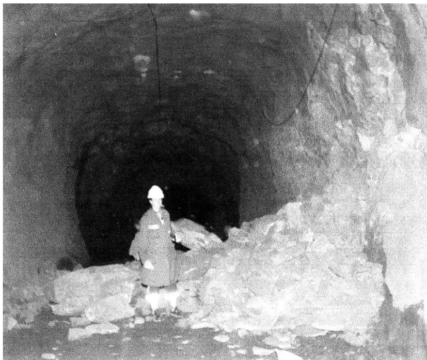
Рис. 3.17. Повреждения, вызванные напряженным выбросом июля 2003 г.
