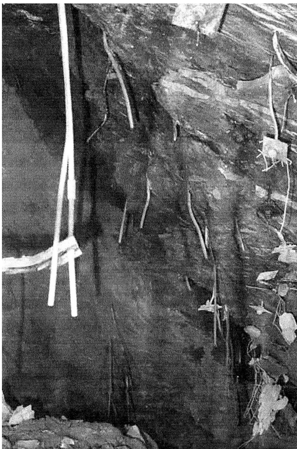
Рис. 2.79. Повреждения крепи квершлага 327
