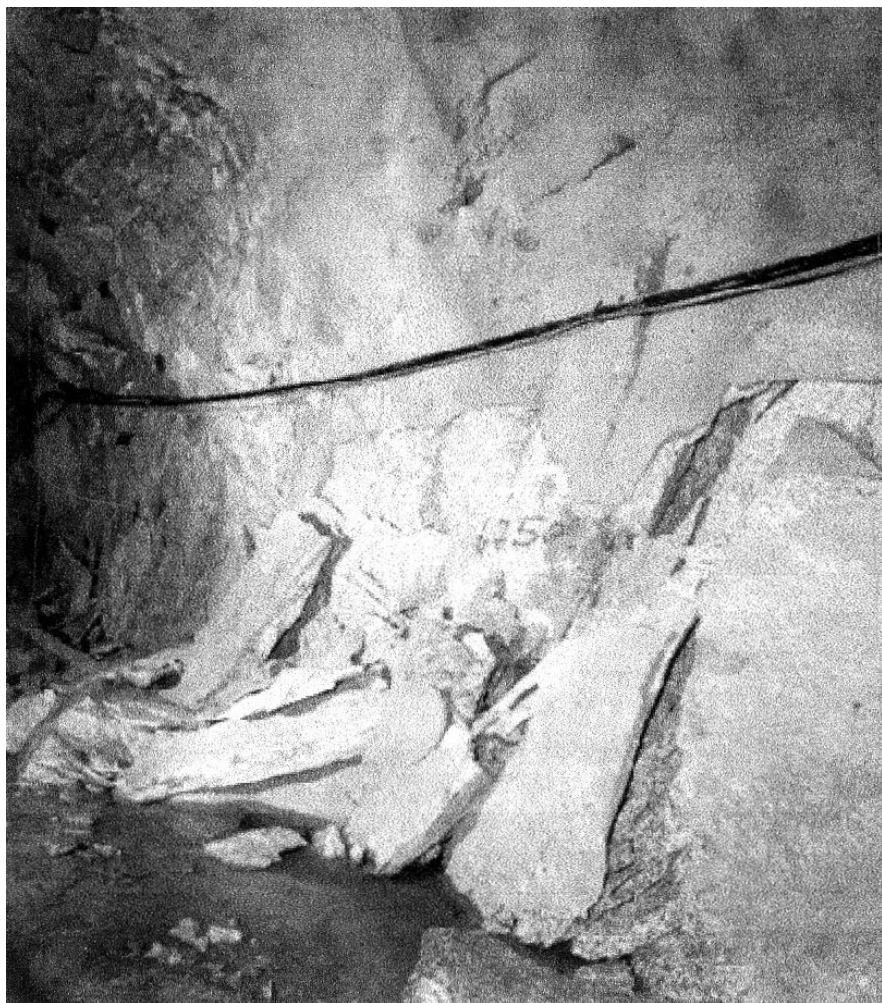
Рис. 4.18 Повреждение внезапным выбросом стены незакрепленного туннеля
