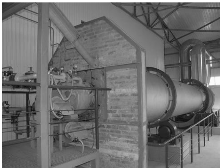
Рис. 1. Линия термического обезвреживания маслосодержащих отходов.
