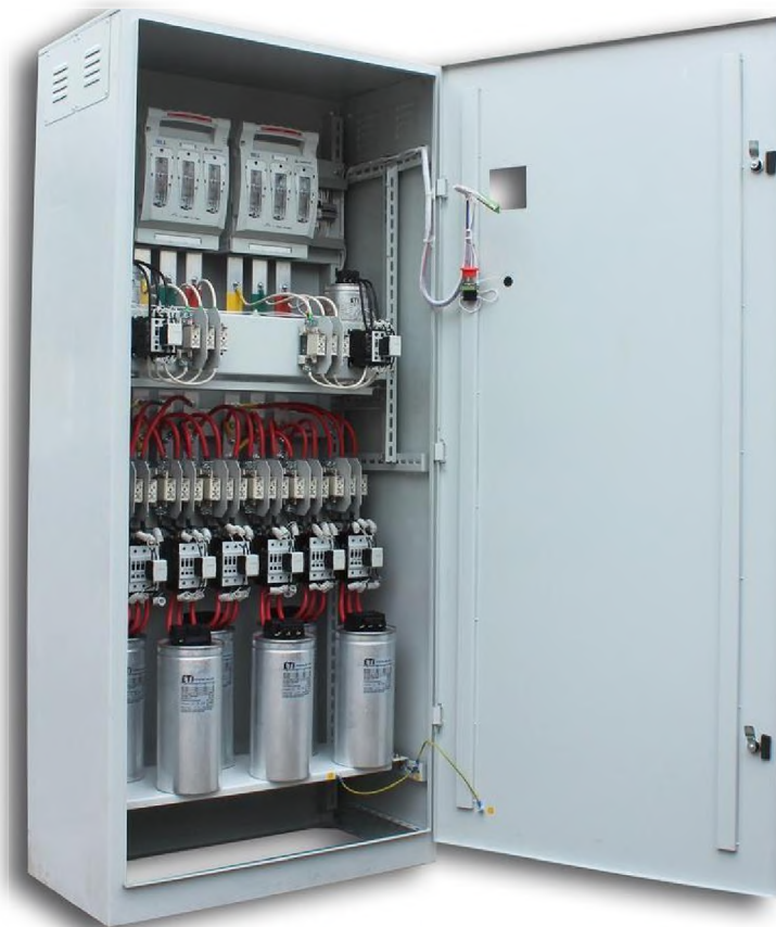
Рисунок 2.1 – Комплектна конденсаторна установка УКРМ 0.4-400/10-40
