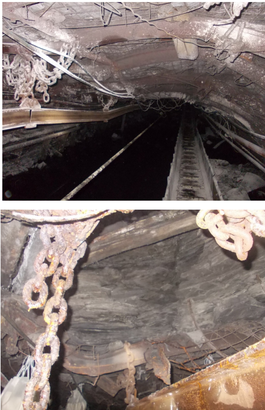
Рисунок 4.10 – Стан конвеєрного штреку ПРАТ ш/у Покровське перед ремонтом
