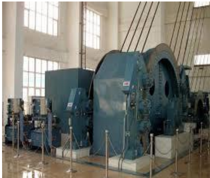
Рисунок 1.9. Фото автоматизованої шахтної підйомної машини
