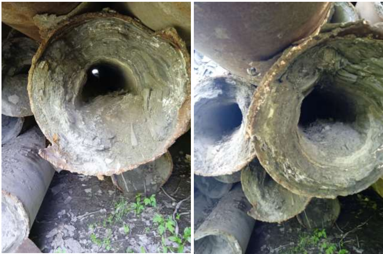
Рисунок 1.6 – Приклад засмічення системи трубопроводів при гідравлічному способі транспортування золи на Кураховській ТЕС
