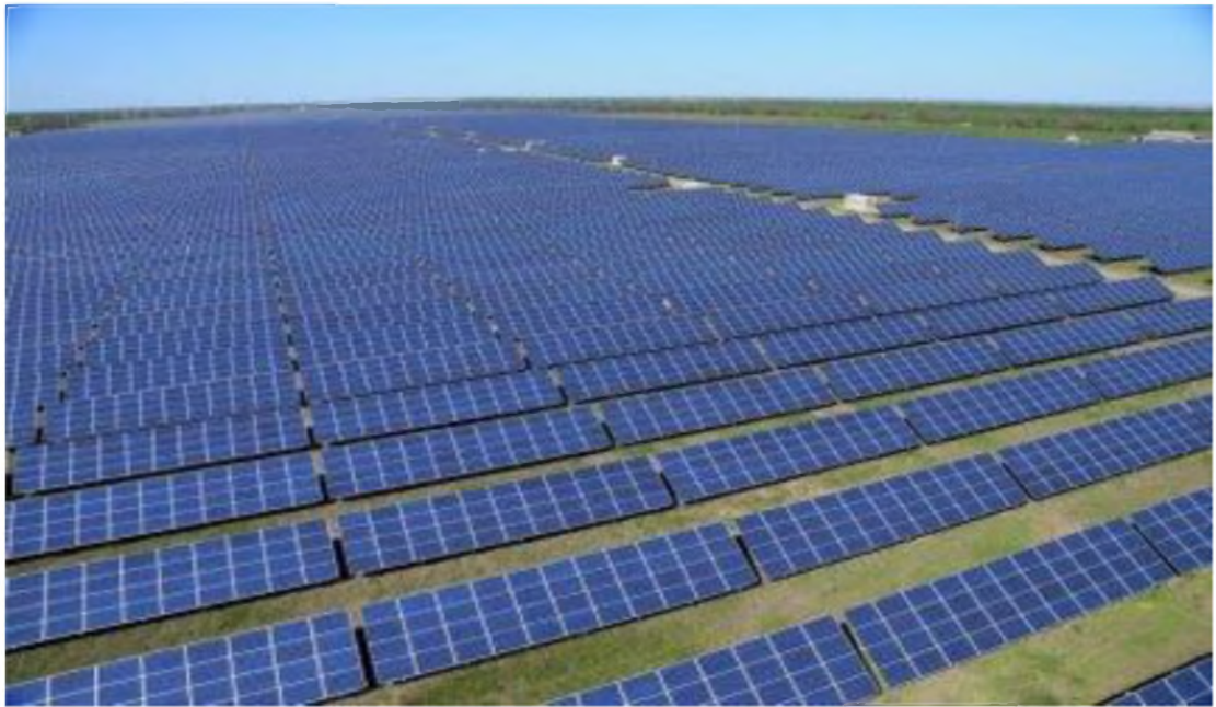
Рисунок 1.5 – Модульна фотоелектрична станція
