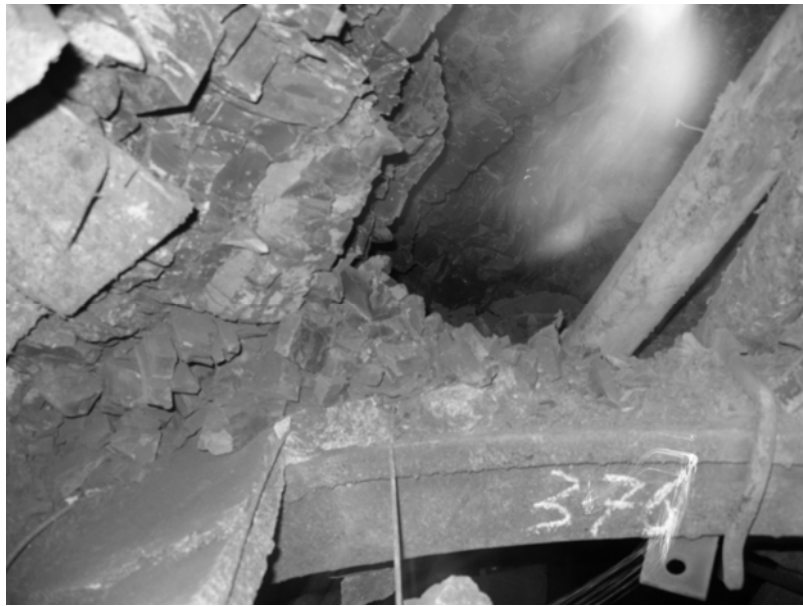
Рис. 4. Общий вид «купола» вывала пород над верхняком крепи конвейерного штрека 8 западной лавы пл. т 3 шахты им. Е.Т. Абакумова
